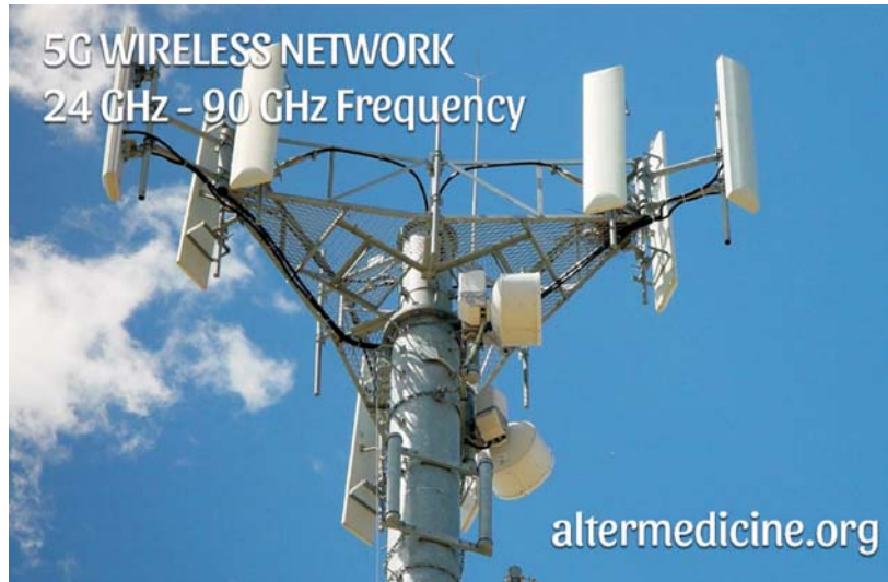
Рис. 1. Передающая станция беспроводных 5G сетей, работающая в диапазоне 24–95 ГГц. Источник: Broad, William J. The 5G Health Hazard That Isn't The 5G Health Hazard That Isn't. The New York Times. July 16, 2019. URL: https://www.nytimes.com/2019/07/16/science/5g-cellphones-wireless-cancer.html (дата обращения 17.08.2020)
