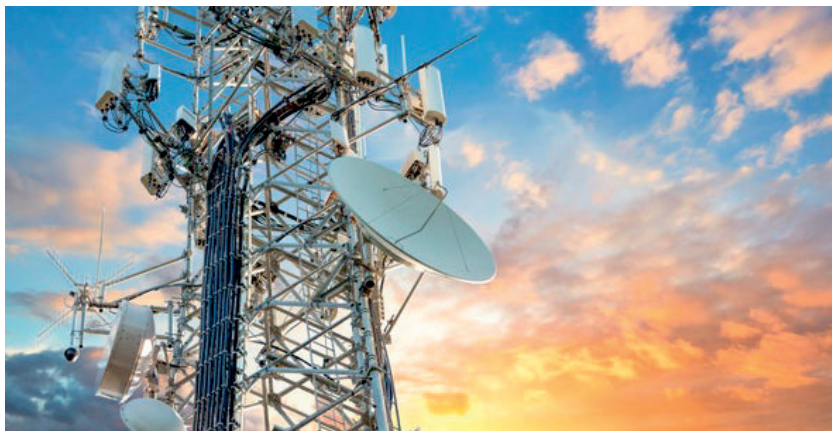
Рис. 7. Передающая станция сетей 5G
